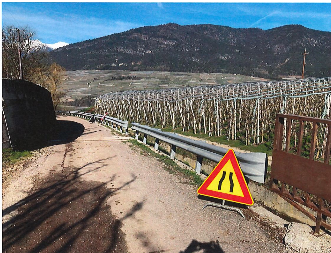
STRADA COMUNALE CON EVIDENZIATO CEDIMENTO BANCHINA
